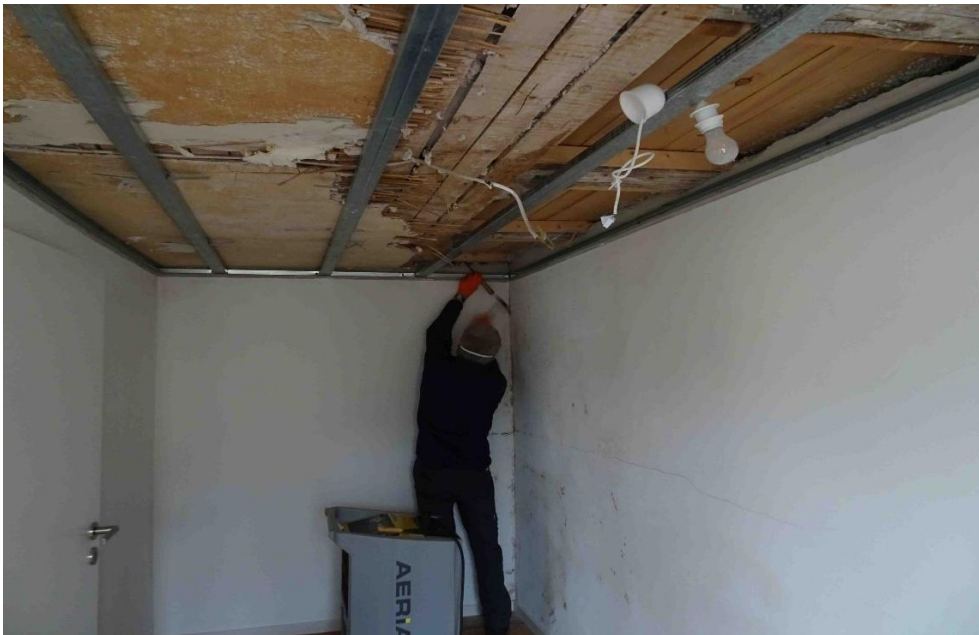
Foto: Privat, Schadstoffprüfung Materialprobe.
